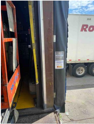
Position 12 - Dock Door
