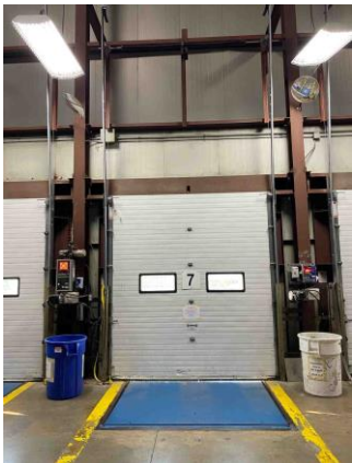
Position 7 - Dock Door
