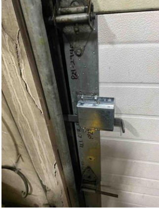
Position 12 - Dock Door
