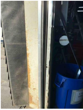
Position 6 - Dock Door
