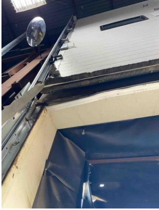
Position 6 - Dock Door
