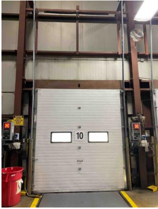
Position 10 - Dock Door
