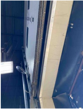
Position 6 - Dock Door
